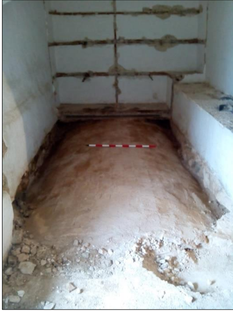
FOTO 29. Vista del buidat del rebliment de la volta ubicada a la crugia més meridional.
