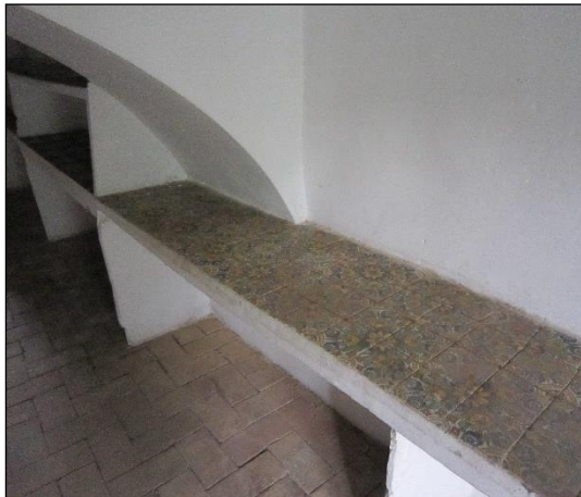
FOTO 15. Detall de les prestateries d'obra enrajolades que tenia la "sala del pa".
