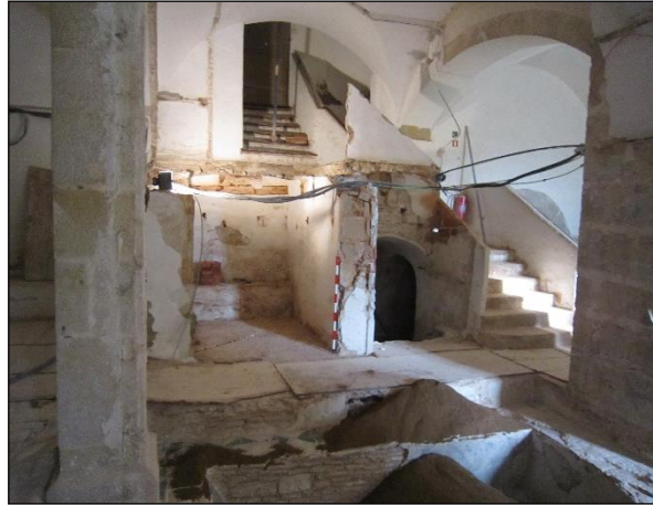
FOTO 34. Vista vers el nord de l'espai que ocupaven les dues fresqueres un cop retirat tot l'altell. Al fons, els àmbits també de magatzem aprofitats sota l'escala d'accés al claustre..
